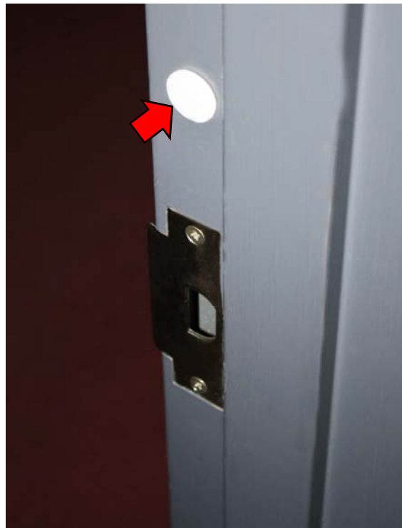
FIG. 13C: DOOR CONTACT MAGNET INSTALLED IN DOOR JAMB
