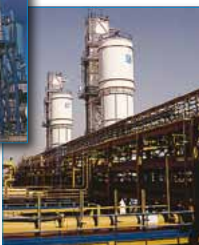
Stockage de gaz
