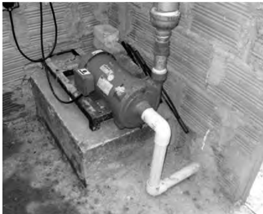
Figura 40. Unidad impulsora de agua.
