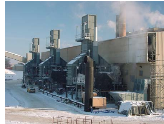
Six Hitachi H25 units, IST HRSGs
