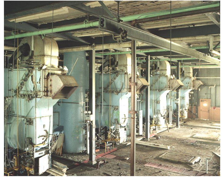
Pinetree Line, Old HRSG Boilers
