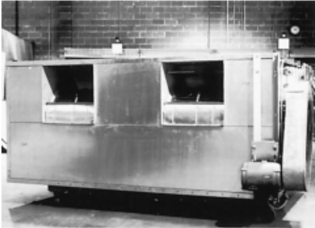
Discharge of fan section
