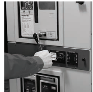
Levering Magnum DS Breaker
