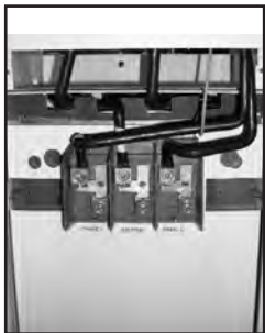
Utility Lug Landing
