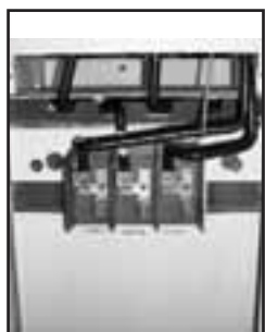
Utility Lug Landing
