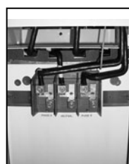
Utility lug landing
