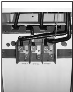
Utility Lug Landing
