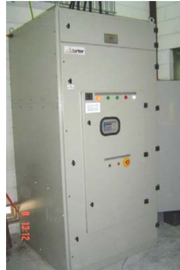
Soft Starters 6600V, 250A Blower Fan
