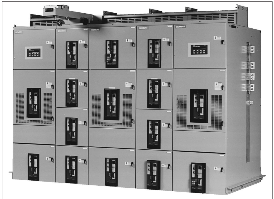
480 Volt Metal-Enclosed Switchgear
