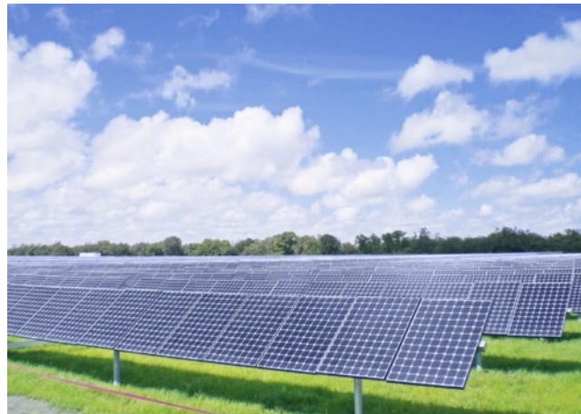
Desoto (Florida, USA): 27 MW (2009)
