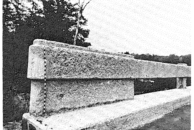
Fig. A.2.9.4.b—Scaling severe
