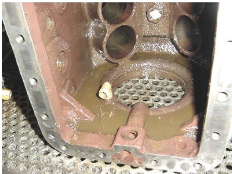
Figura 24: Umidade presente no bloco do compressor (Silva, 2004).
