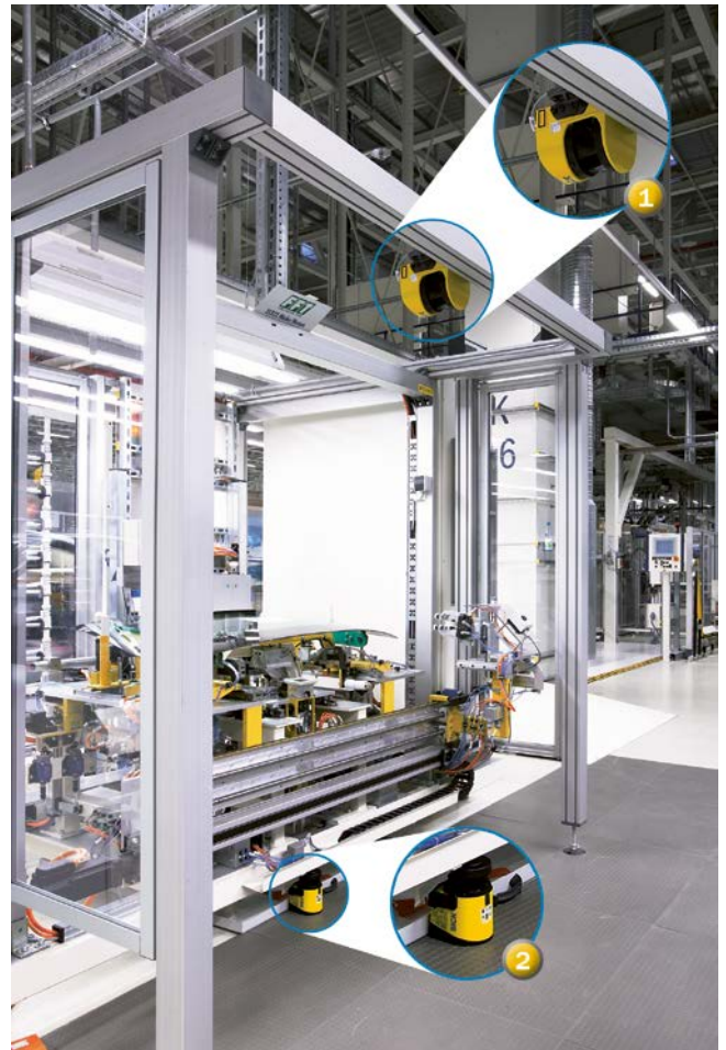
Escáner láser de seguridad en una estación de mecanizado como función de seguridad pos. 1, activar parada y función de seguridad pos. 2, impedir el arranque (detección de presencia)
