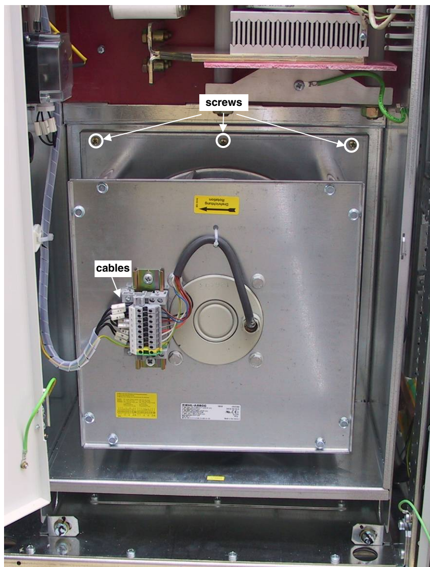
Converter fan in frame D6
