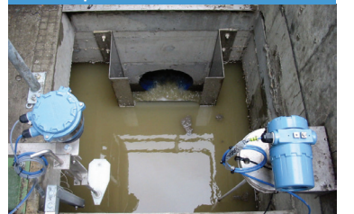
3100 and 3300 on effluent sump
