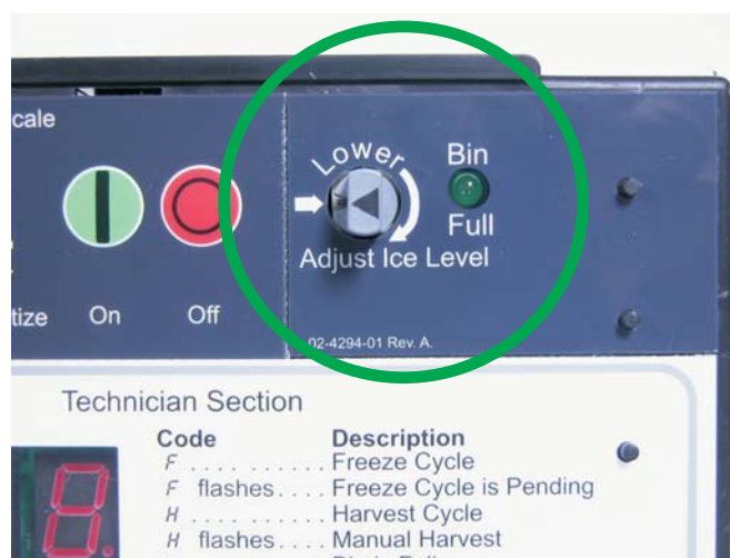
Control ultrasónico mostrado en su posición instalada, configuración a llenado máximo.
