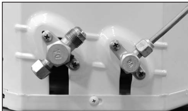
FIG. 57 - CONEXÃO DA LINHA DE EXPANSÃO DA UNIDADE CONDENSADORA
