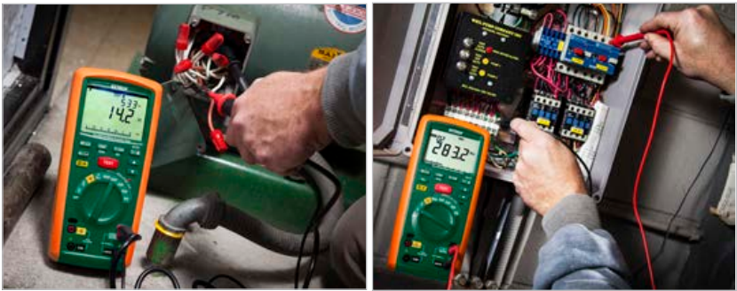
Verificação de tensão em um torno e teste de isolamento em um motor de bomba
