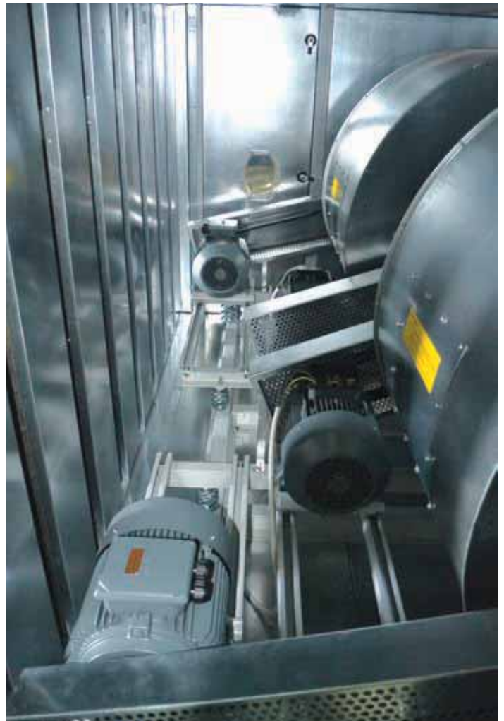
Dual fan and run & standby motor
