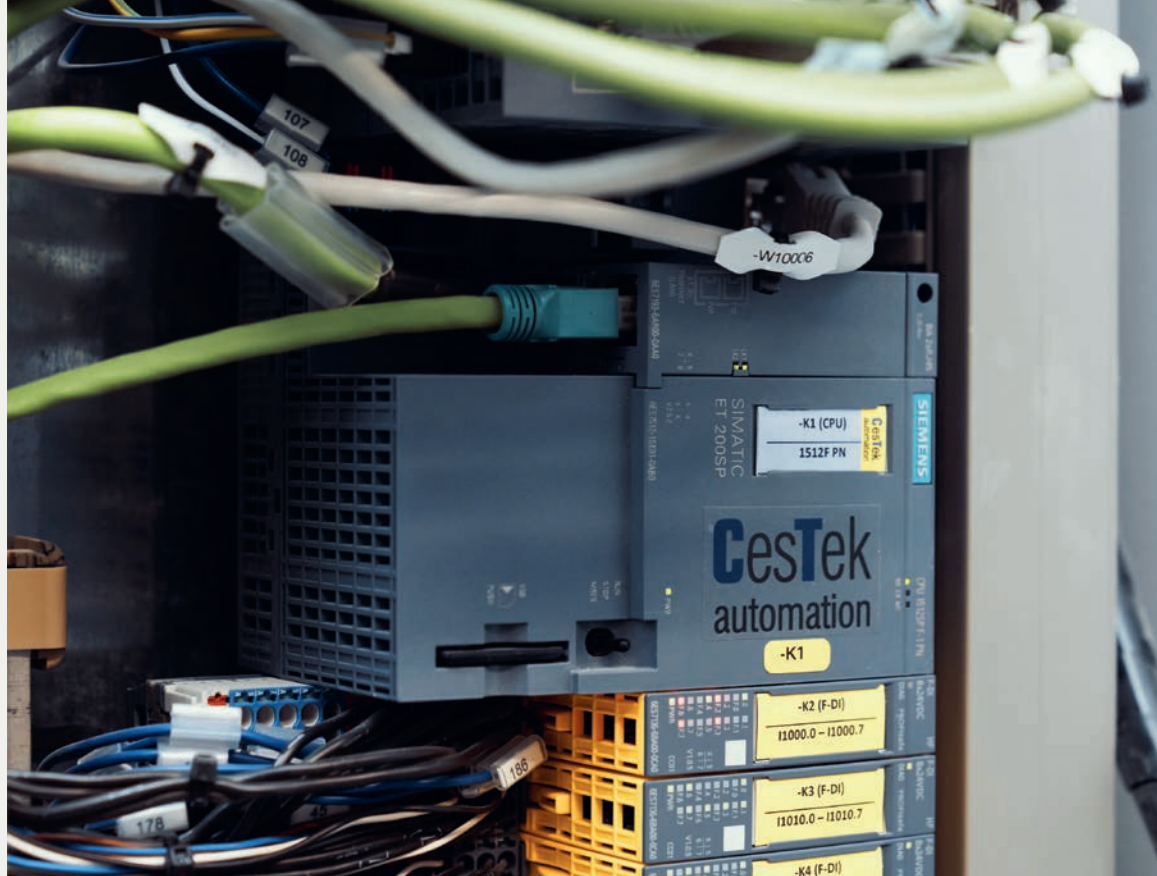
Nem at installere, ekstremt brugervenlig og kompakt, så den passer i et lille skab. SIMATIC ET 200SP er hjertet i automationsstyringen.
