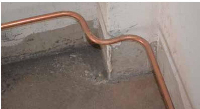
Equipotential grounding conductor
