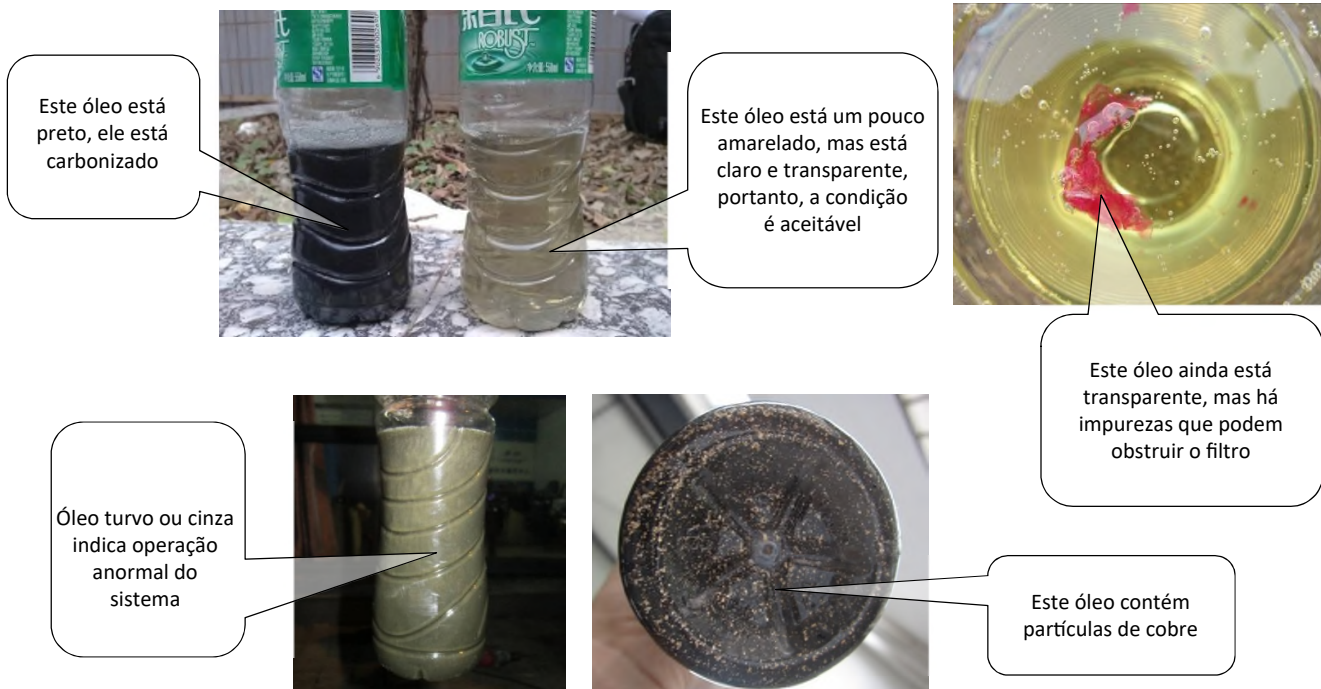
Figura 91: Inspeção do óleo do compressor
