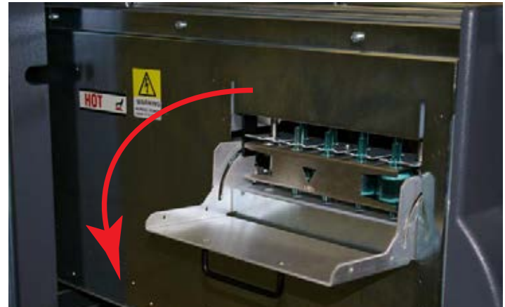
Pyrolyzer Filter Door
