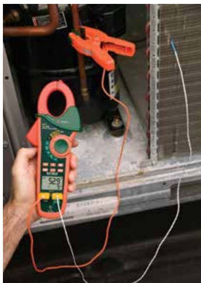
Deux entrées type K pour mesurer les différences de température dans les cas de surchauffe.
