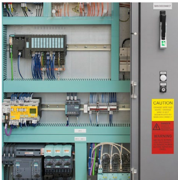
Afbeelding 13-8 Voorbeeld van waarschuwingsinformatie op de behuizing van een industriële besturingskast
