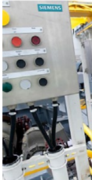
Afbeelding 11-14 Leidingen in kabelkanalen
