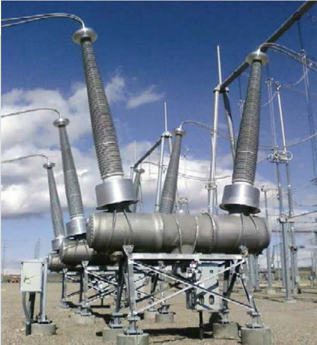
Fig. 15: 3AP2 DT 550 kV
