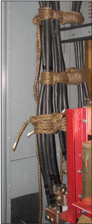
Figure 25 – Exemple de l'entrave de câble
