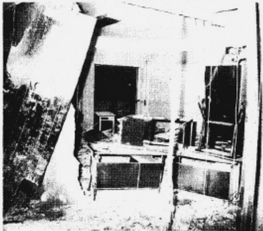
O interior da embaixada com as portas completamente destruídas e os estêres e vidros totalmente destruídos
