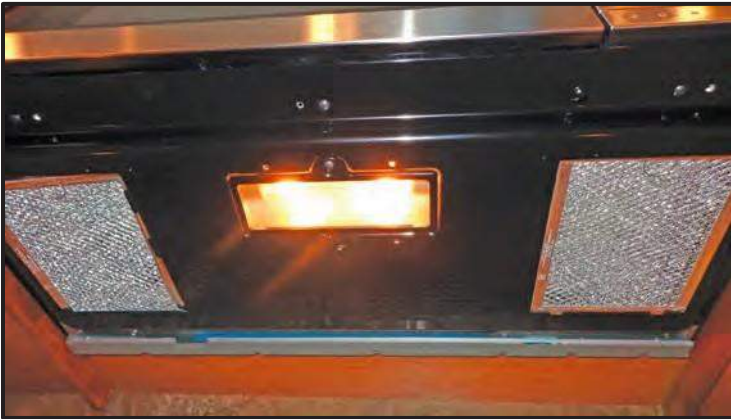
Figure 5-4: Air Filtration Fan
