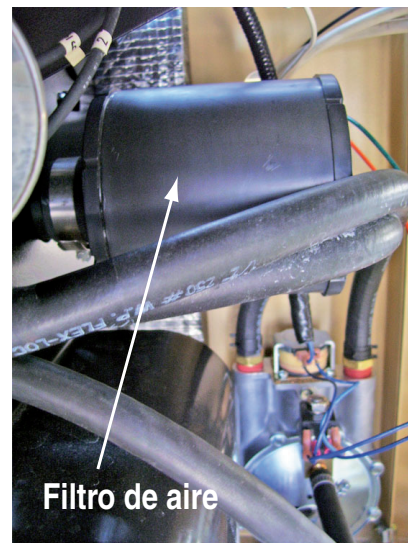
Figura 4.6 — Limpiador de aire del motor de 10kW
