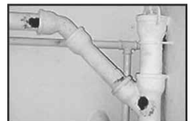
De la rouille sur des tuyaux ou d'autres pièces de chauffage, de plomberie ou de climatisation sont aussi un signe d'humidité trop élevée.
