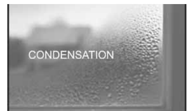
De la condensation sur une fenêtre est une indication d'humidité trop élevée.
